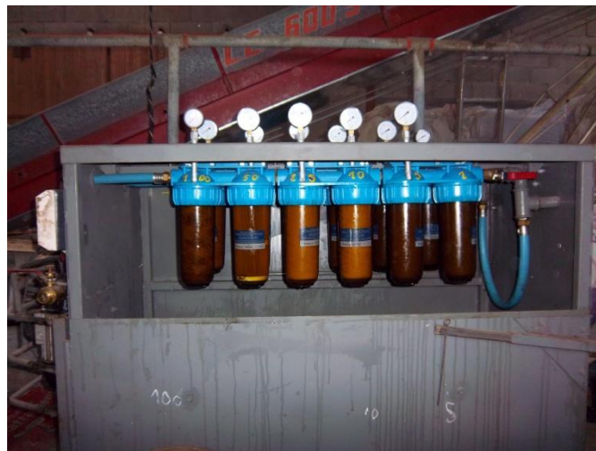
Système de filtration de l'HVP
